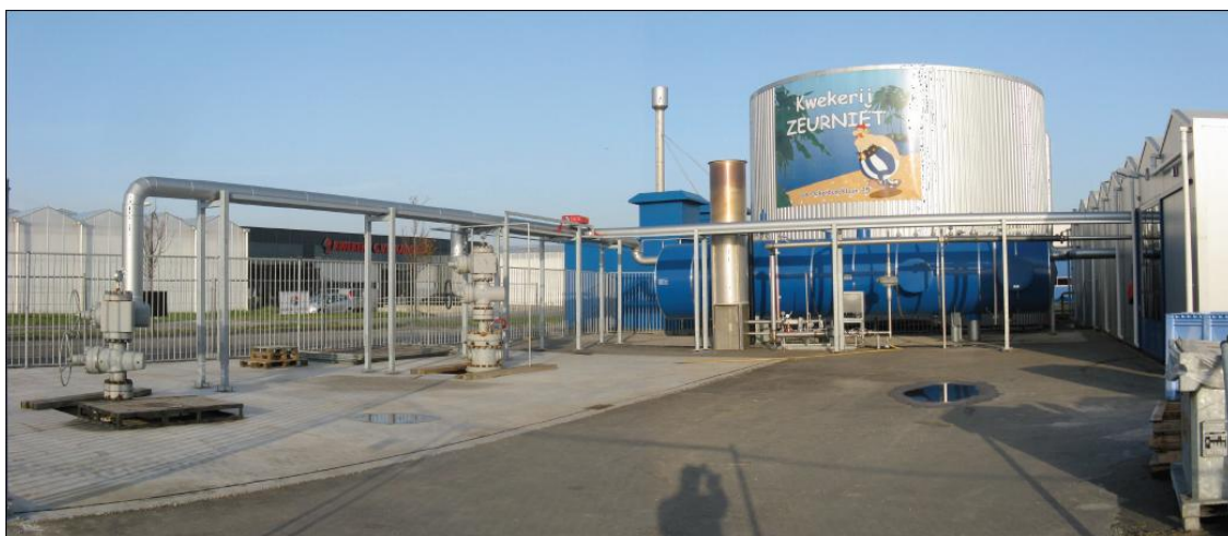
Afbeelding 4.4 – Bovengrondse deel van de geothermiebron van GWW (Green Well Westland, 2012b)
